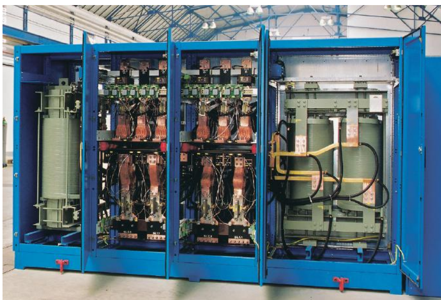
Установка преобразователя частоты на 12.000 кВт
