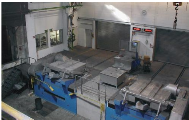
Платформа печи, установка MFT Ge 8.000 / 6.000 кВт
